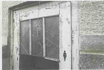
Kaputte Tür im Untergeschoss.
