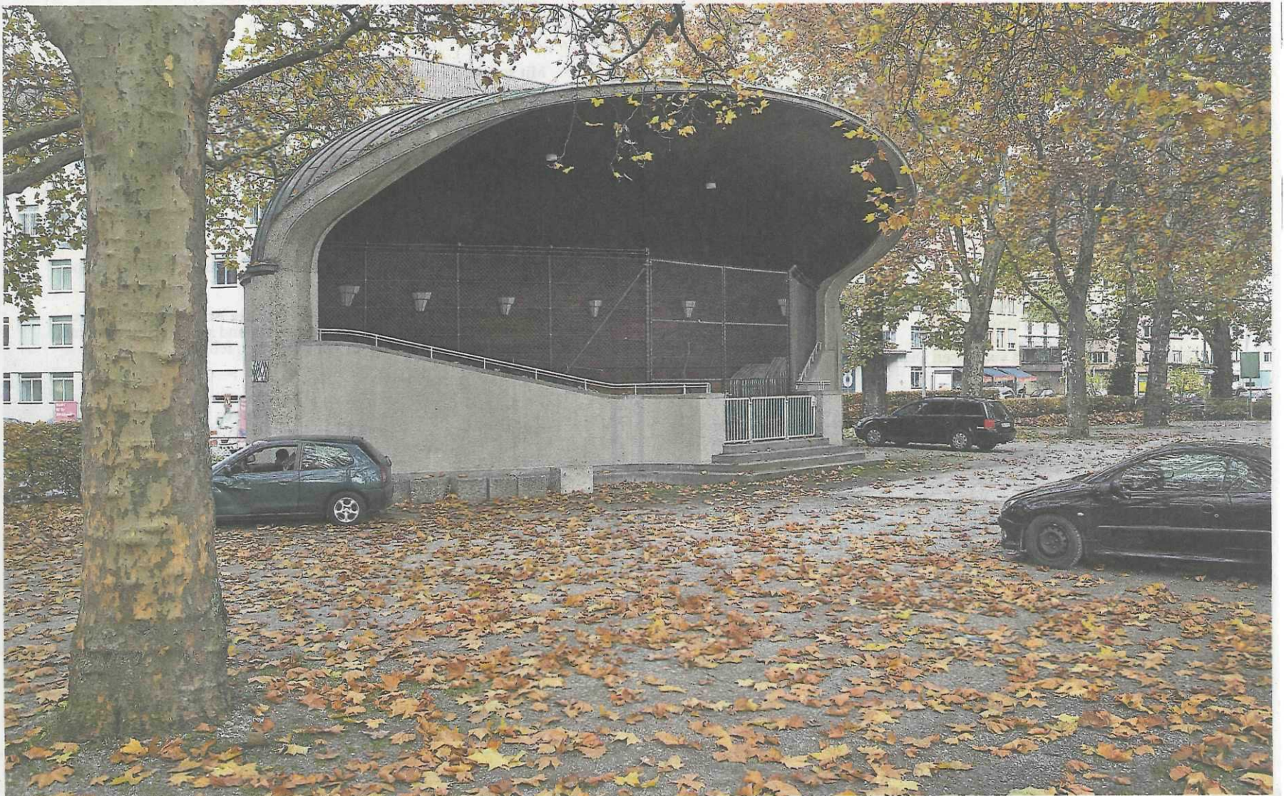
Heruntergekommenes Schutzobjekt: Der zugesperrte Pavillon an der Manessestrasse in Wiedikon fristet ein Schattendasein. Fotos: Dominique Meienberg
